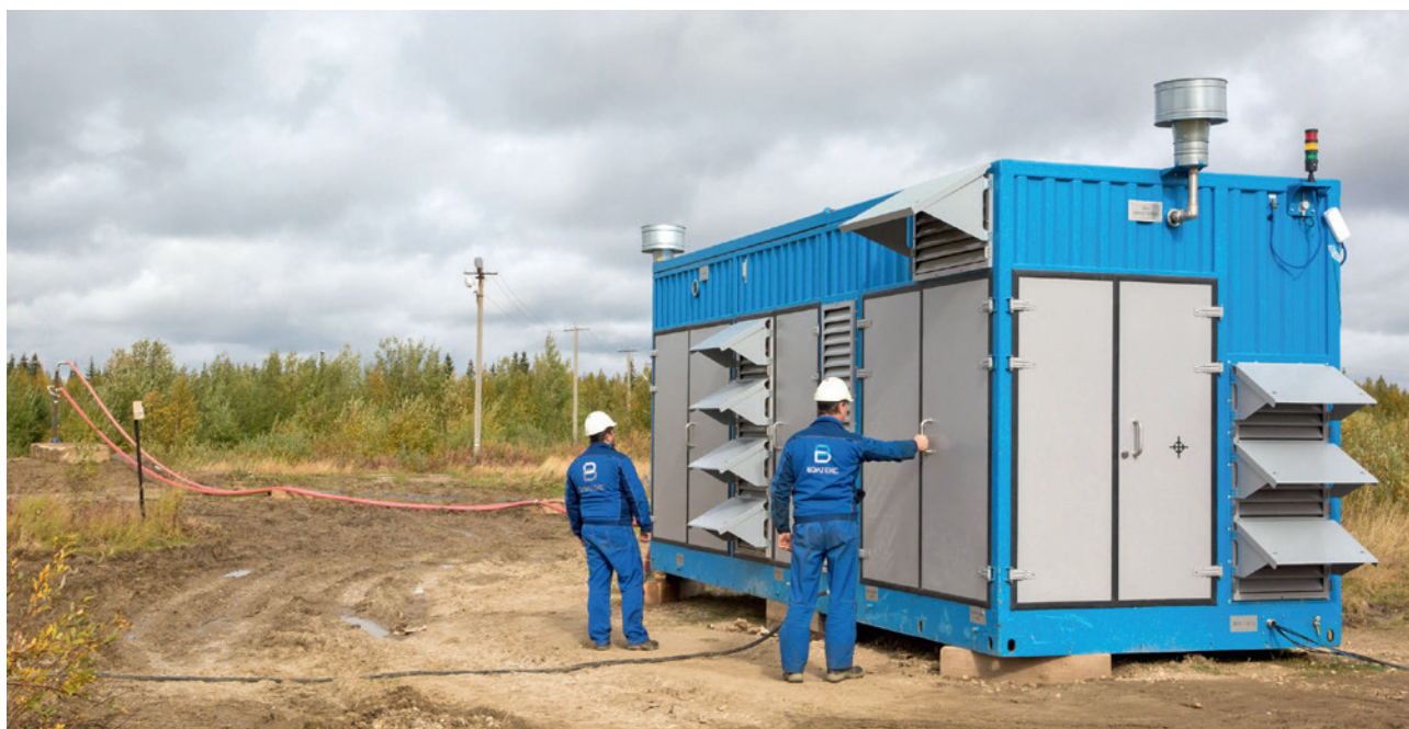
Температура точки росы, измеренная непосредственно внутри трубопровода, составила –41 °С и оказалась значительно лучше требований нормативной документации ПАО «Газпром»
